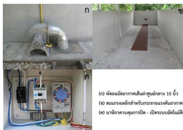
อุปกรณ์หลักที่ใช้ในระบบการเติมอากาศ
